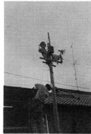
引込電々継柱訓練
